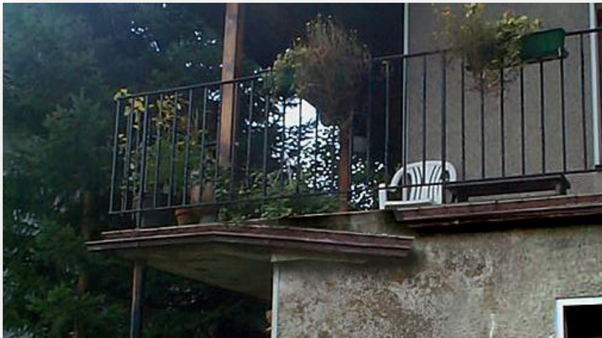
Quelle: G. Meyer. Defekte Dachrinne an einem Balkon.
