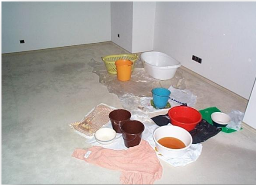
Quelle: Georg Meyer ( kleiner Schaden, große Wirkung)
