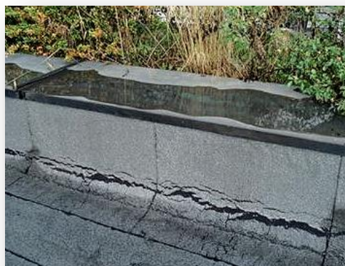
Quelle: Georg Meyer ( Defekte Anschluss an einem Flachdach und Risse in der Dachabdichtung)
