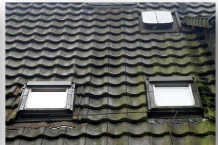
Undichte Velux-Fenster durch Laub und Moos am Eindeckrahmen
